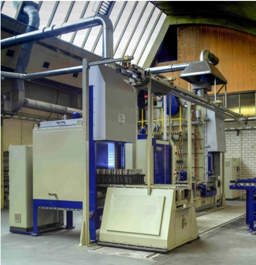
Abb. 36 Mehrzweckkammerofenlinie mit Anlassofen, Waschanlage und Mehrzweckkammerofen
