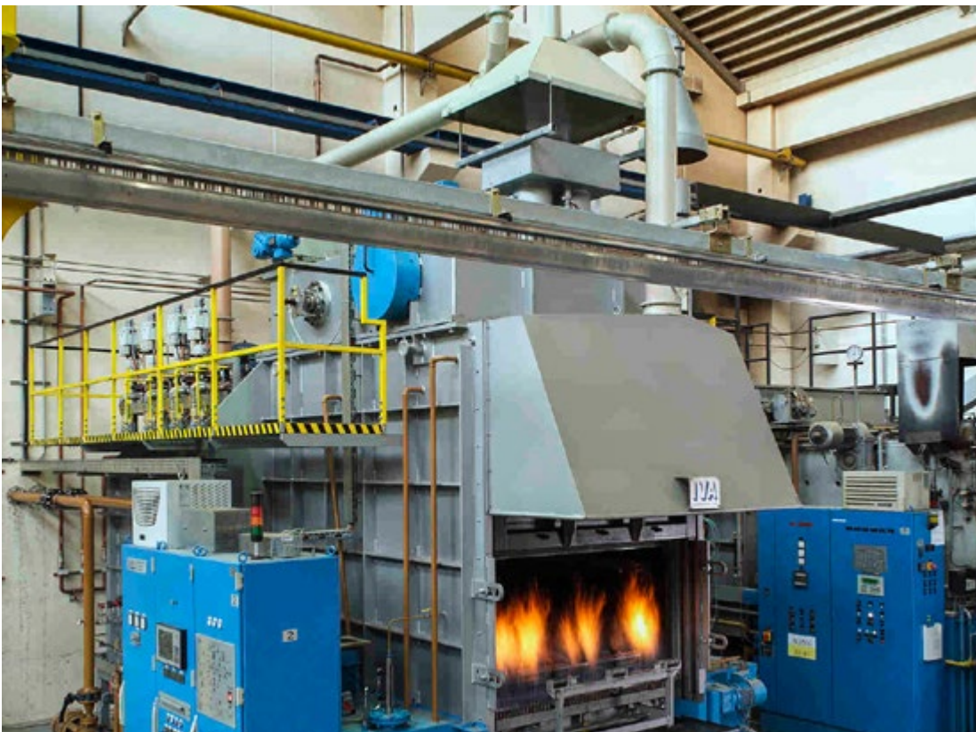
Abb. 17 Absaugungen an einem Mehrzweckkammerofen
