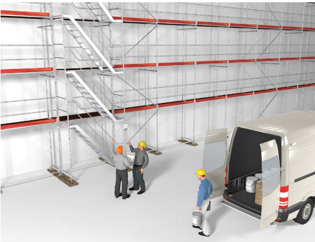
Abb. 91 Gerüst vor Verwendung auf offensichtliche Mängel prüfen
