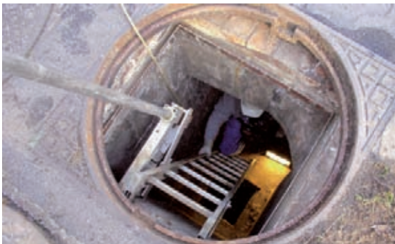
Bild 28: Sicherung des Pumpensumpfes durch Einsteigleiter
