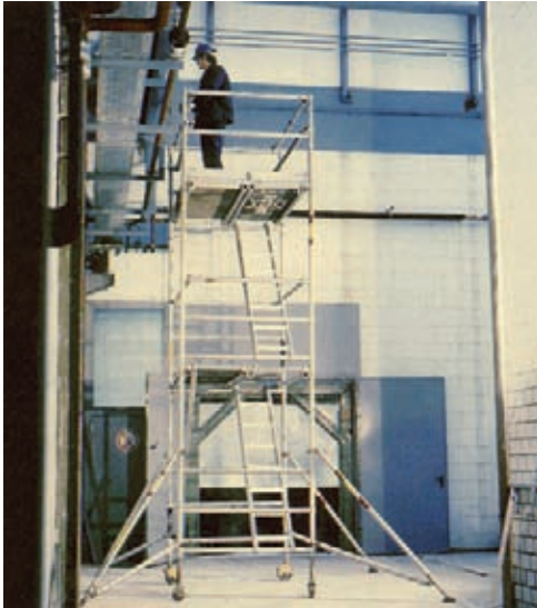
Bild 10: Fahrerüst zur Instandhaltung
