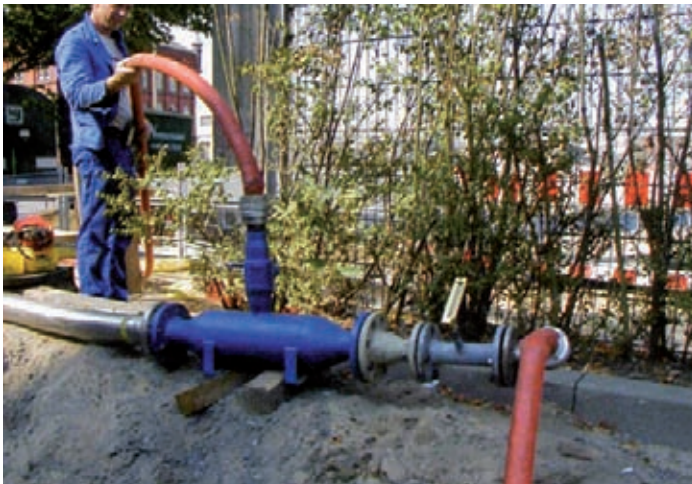
Bild 23: Abkühlen des Mediums mittels Mischkühler
