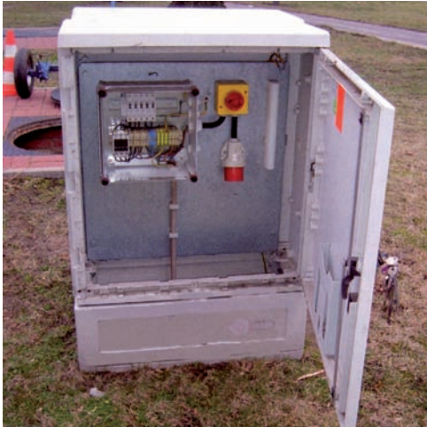
Bild 16: Speisepunkt außerhalb des Schachtes
