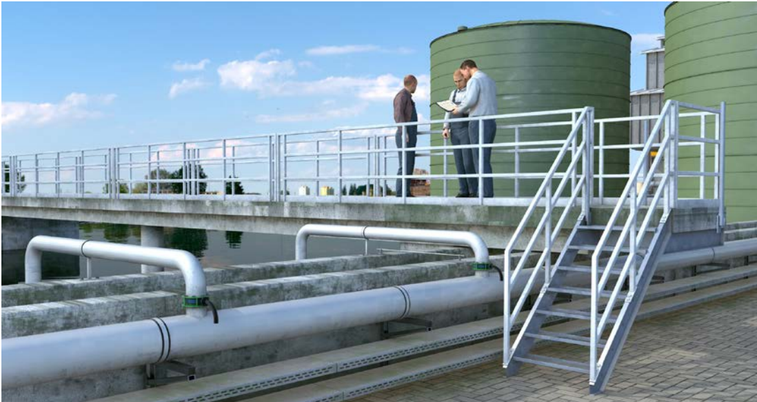
Abb. 8 Geländer sichern Beschäftigte an Treppen und Beckenrändern.
