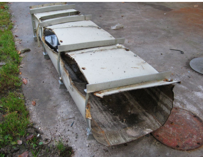
Abb. 29 Zerstörte Filterelemente (Quelle: BGN)
