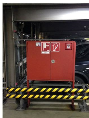
Abb. 50 Vor Beschädigungen und Witterungseinflüssen geschützte Feuerlöscheinrichtungen
