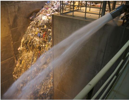
Abb. 63 Stationäre Schaumlöschanlage in einem Abfallbunker
