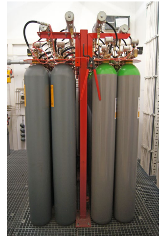
Abb. 62 Flaschenstation einer Gaslöschanlage
