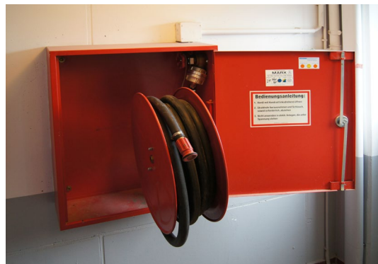
Abb. 67 Wandhydrant als Selbsthilfeeinrichtung
