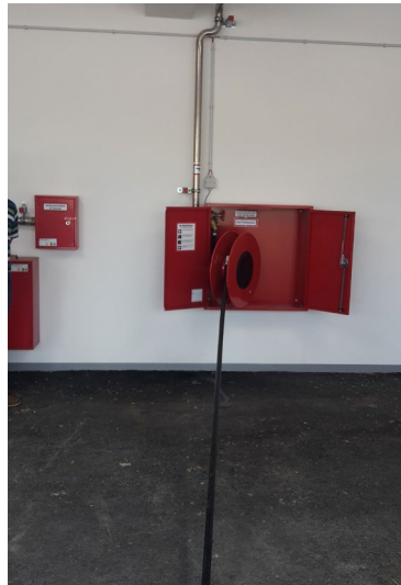
Abb. 54 Verwendung eines Wandhydranten zur Entstehungsbrand-bekämpfung
