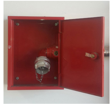
Abb. 65 Entnahmestelle einer trockenen Löschwasserleitung
