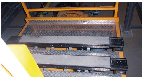
Abb. 11 Lastaufnahmemittel begehbar ausgeführt
