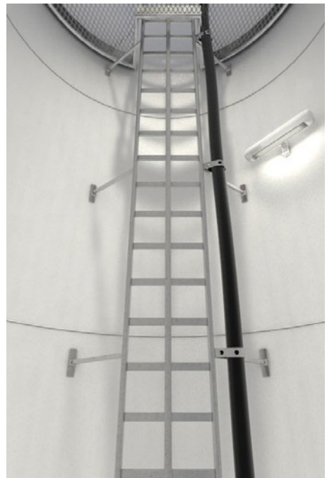
Abb. 20 Steigleiter in einer Windenergieanlage
