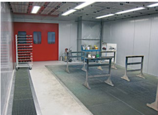
Abb. 1 Lackiererraum mit eigenem Ablüftungsbereich
