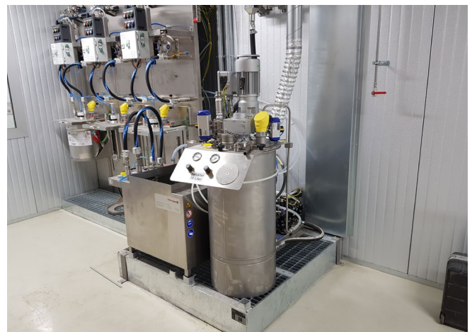
Abb. 29 Auffangwanne als Rückhalteeinrichtung
