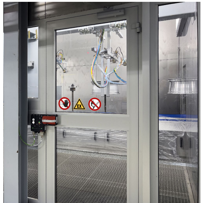
Abb. 23 Kennzeichnung an einem Zugang zu einer Lackierkabine
