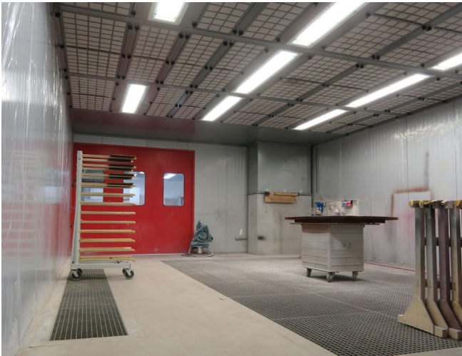
Abb. 38 Lackerraum, links Bodenabsaugkanal für frisch beschichtete Teile
