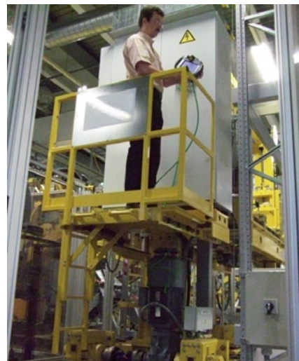
Abb. 59 Fester Zugang zum Schaltschrank mit Steigleiter und Podest [H]
