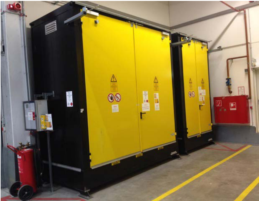
Abb. 8.2 Sicherheitsschrank zum Lagern von Gefahrstoffen
