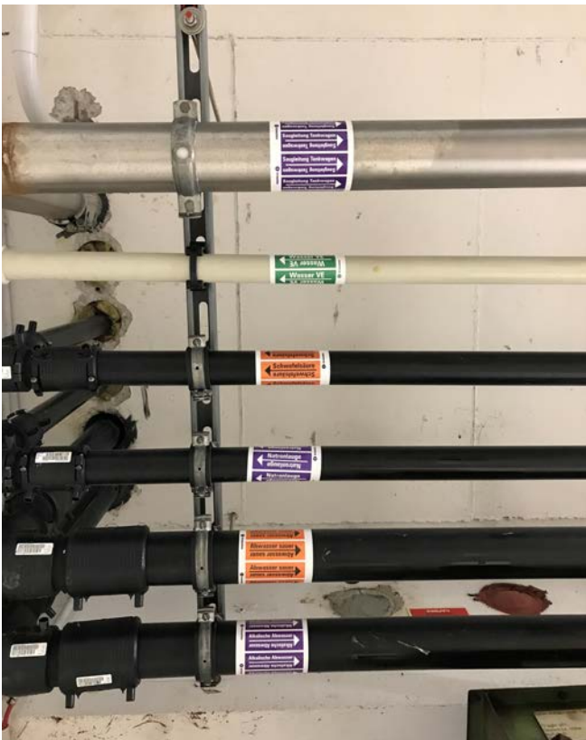
Abb. 2.5 Kennzeichnung von Rohrleitungen nach TRGS 201
