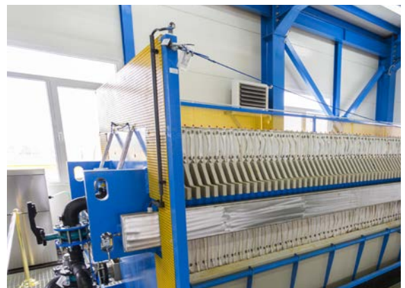
Abb. 12.2 Kammerfilterpresse mit Sicherheitseinrichtung – auch solche Betriebseinrichtungen müssen regelmäßig geprüft werden
