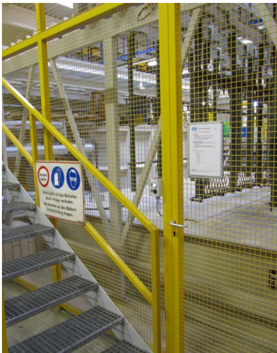
Abb. 2.1 Abgesicherter Zugang zum Galvanikbereich (Galvanoautomat)
