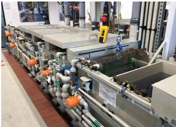
Abb. 4.2 Abgedeckte Prozessbehälter mit Randabsaugung
