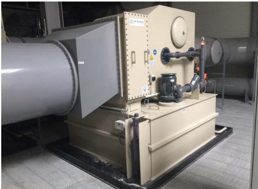
Abb. 9.1 Wiederkehrende Instandhaltung am Nasswäscher einer Abluftanlage
