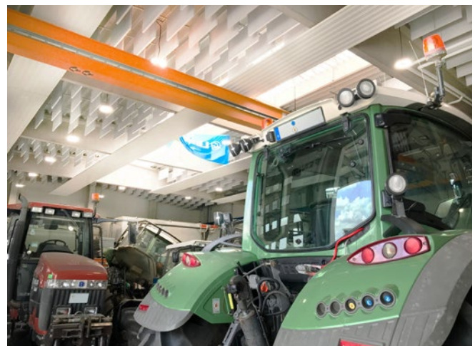
Abb. 37 Nachträglich mit Baffles raumakustisch verbesserte Werkstatt
