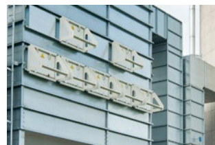
Druckentlastung über Explosionsklappen
