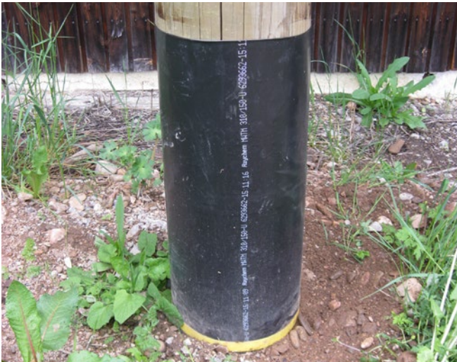
Abb. 2.1.1.2 Holzmast mit beispielhafter Markierung der Eingrabbtiefe
