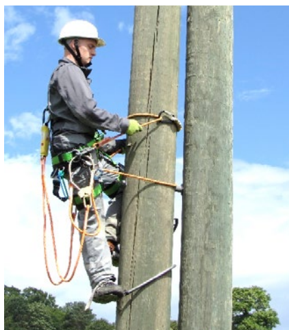
Abb. 7.8.2.e Beispiel für das Besteigen eines Doppelmastes: Die eingesetzte persönliche Schutzausrüstung gegen Absturz sowie deren Verwendung entspricht der für das Besteigen von A-Masten
