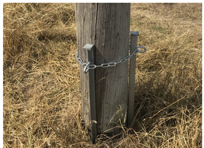
Abb. 7.6.3 Beispiel für eine Mastfußsicherung
