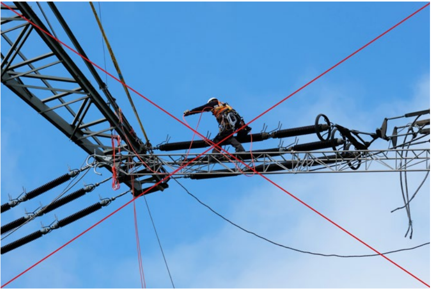
Abb. 104 Die über eine lange Strecke herausgezogene bewegliche Führung führt verstärkt durch eine Schlaffseilbildung im Fall eines Absturzes von der Montagebühne zu einem Pendelsturz mit erheblicher Fallhöhe.
