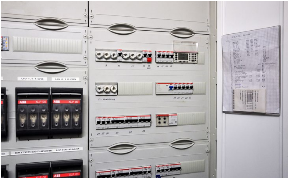
Abb. 4 Stromkreiskennzeichnung und zugehörige Dokumentationen einer elektrischen Unterverteilung
