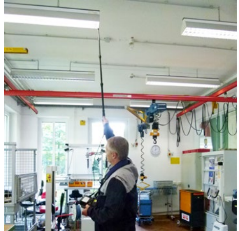
Abb. 9 Messung der niederohmigen Schutzleiterverbindung; Leuchte
