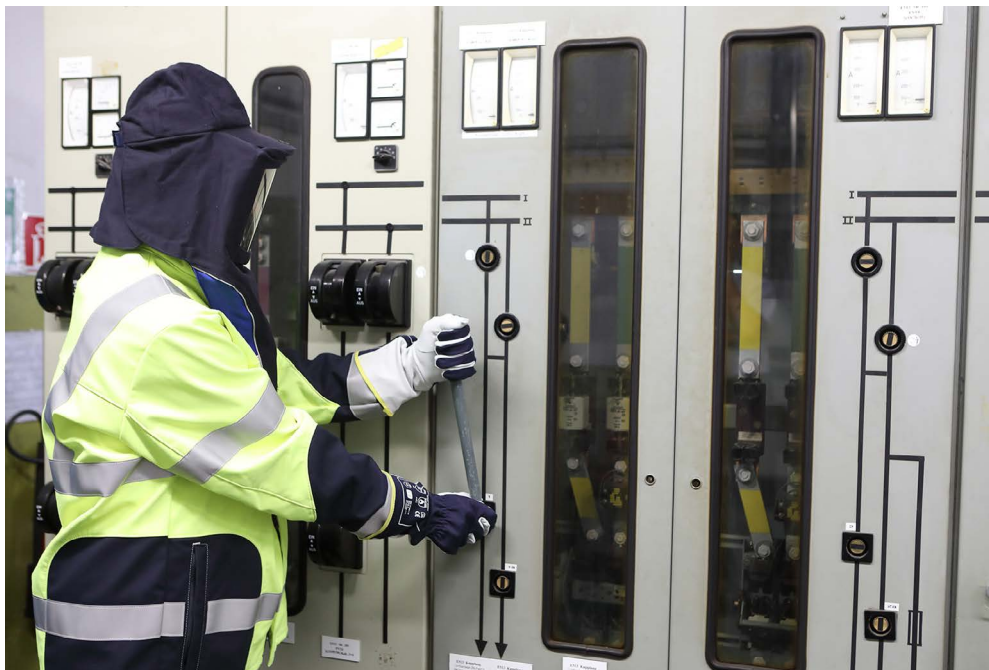
Abb. A 5-19 Öffnen des Lasttrennschalters bei geschlossener Tür mittels Bedienhebel
