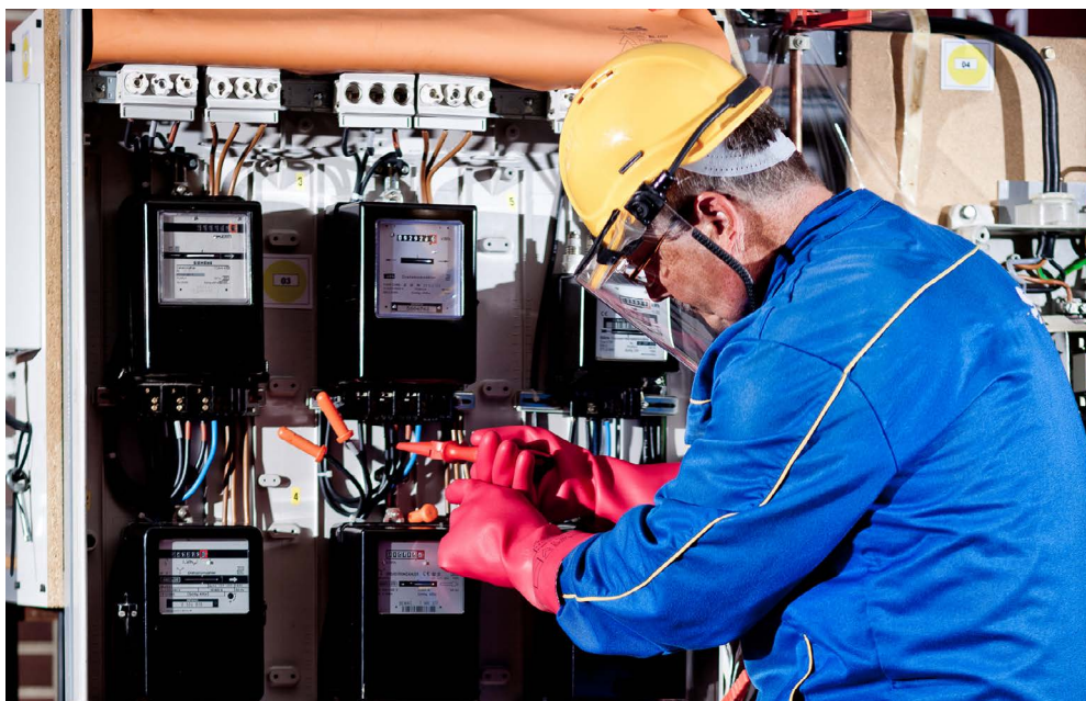
Abb. A 5-10 Arbeiten hinter der Hauseinspeisung
