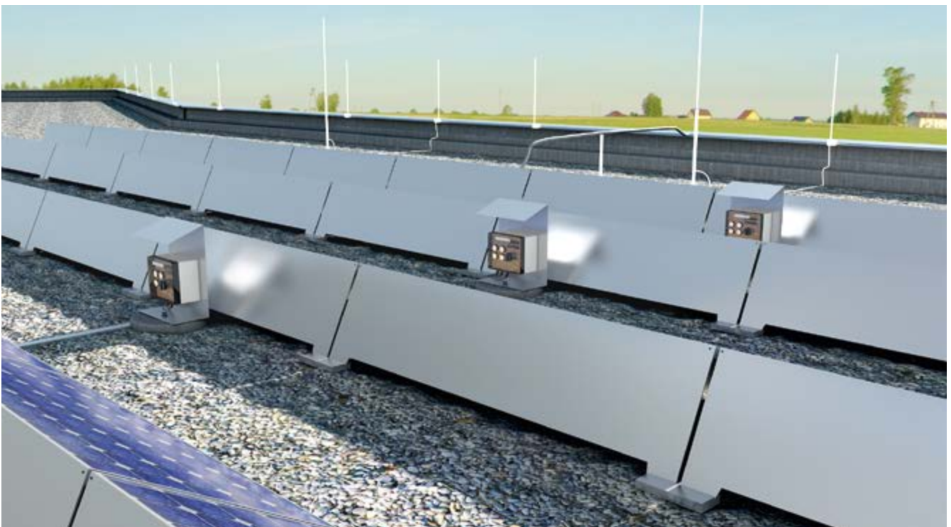
Abb. 35 Beispiel einer Blitzschutzanlage in Kombination mit einer PV-Anlage
