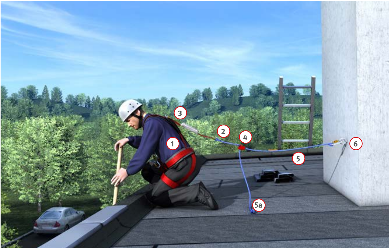
Abb. 6 (1) Auffanggurt, (2) Verbindungsmittel, (3) Falldämpfer, (4) mitlaufendes Auffanggerät, (5) bewegliche Führung (z. B. Seil, Band), (5a) Seilensicherung Die bewegliche Führung (5) muss am mitlaufenden Auffanggerät so eingestellt werden, dass ein Absturz nicht möglich ist. (6) Anschlagpunkt
