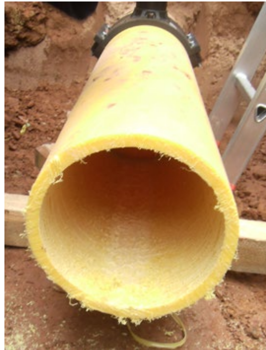
Abb. 11 Rohbiogasleitungen mit Ablagerungen an der inneren Rohrwand
