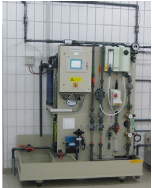
Abb. 7 Chlordioxidanlage nach dem Chlor-Natriumchlorit-Verfahren
