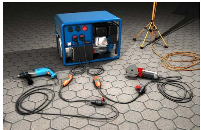
Abb. 16 Jedem Verbrauchsmittel ist eine PRCD vorgeschaltet.
