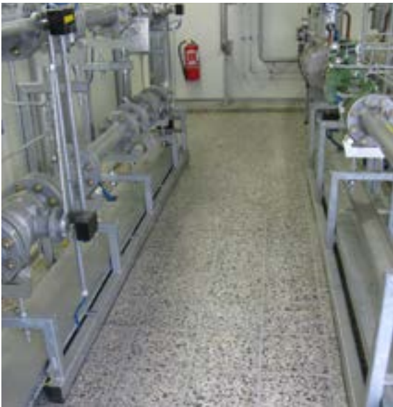
Abb. 33 Aufstellungsraum einer GDRM-Anlage mit ableitfähigem Fußboden
