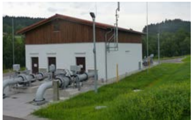
Abb. 29 GDRM-Anlage mit Abblase- und Entspannungsleitung
