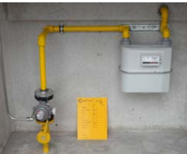
Abb. 16 Gas-Druckregelung im Netzanschluss
