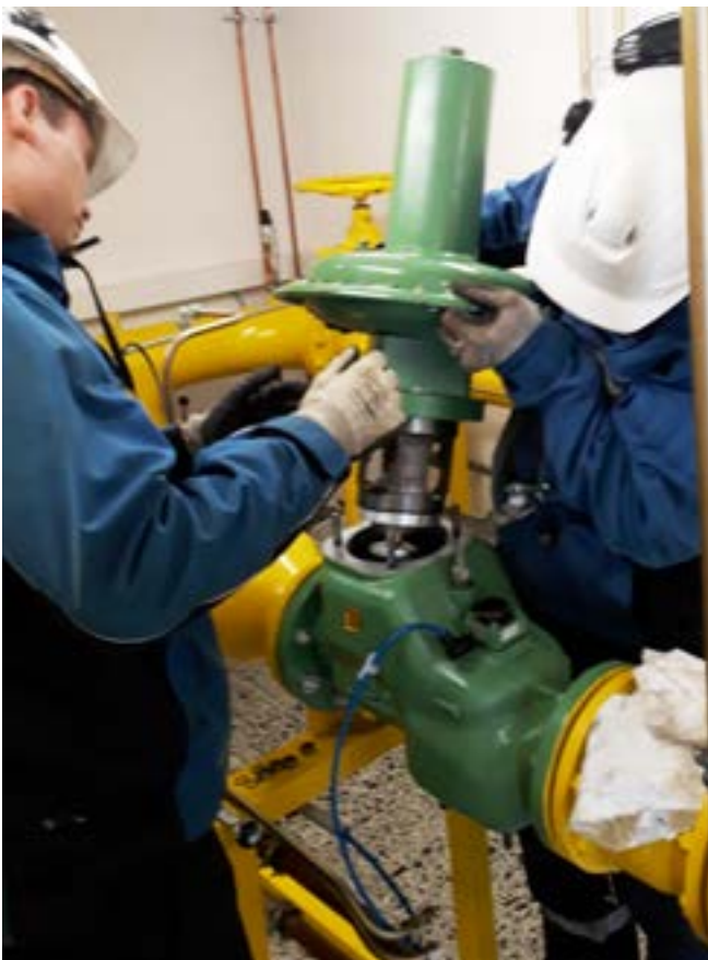
Abb. 11 Wartung eines Regelgerätes
