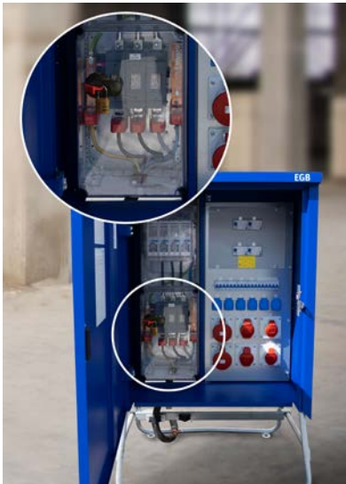
Abb. 9 Baustromverteiler mit Festanschluss
