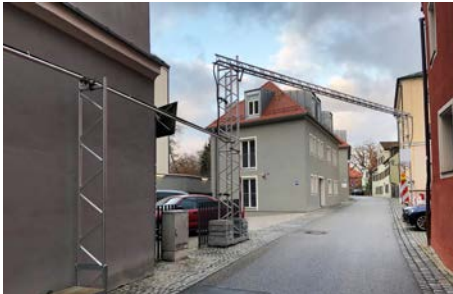
Abb. 1 Hochgelegte Leitung zur Straßenquerung (Kabelbrücke)
