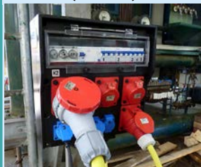
Stromverteiler mit Steckdosen (stationär)
