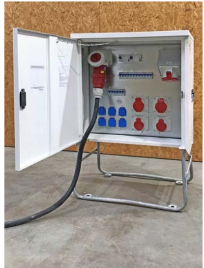
Abb. 10 Baustromverteiler mit Gerätestecker
