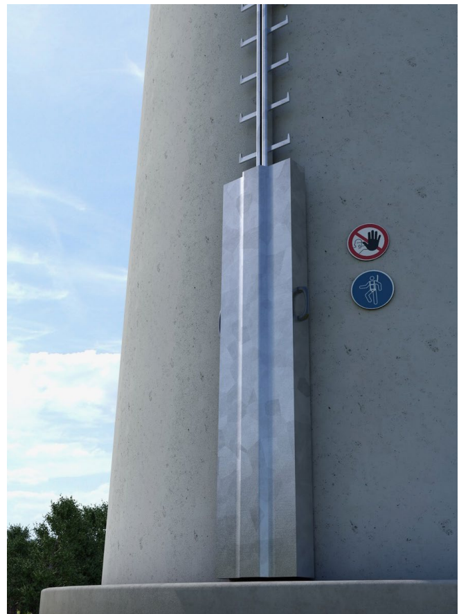
Abb. B1-2 Steigleiter mit Sicherung gegen unbefugte Benutzung
