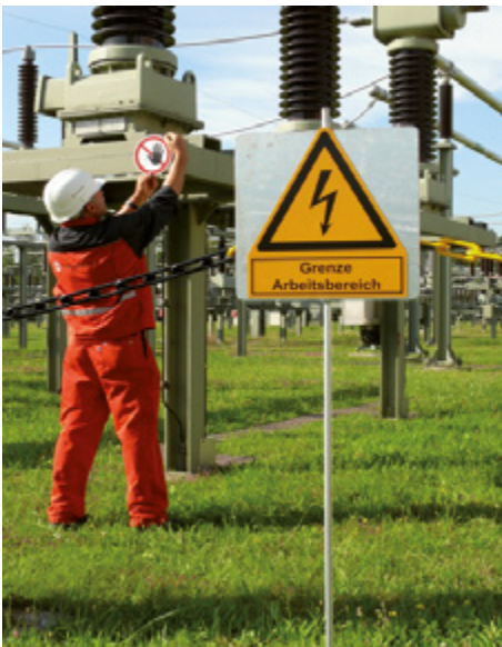
Bild 4: Beispiel zur Abgrenzung und Kennzeichnung des Arbeitsbereiches durch Verwendung von gelb-schwarzen Ketten mit dem Warnschild. Der Gefahrenbereich wird hier zusätzlich mit Hilfe eines Verbotsschildes durch den Anlagenverantwortlichen gekennzeichnet
