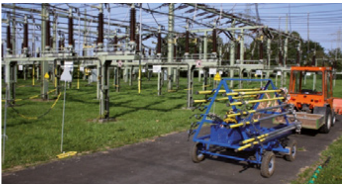
Bild 13: Kennzeichnung eines zum Arbeiten freigegebenen Schaltfeldes mit Zugang von der Fahrstraße. Kennzeichnung mit gelb/schwarzen Ketten und Anwendung des Verbotsszeichens D-P006 für benachbarte unter Spannung stehende Anlagen und Schaltgeräte.
