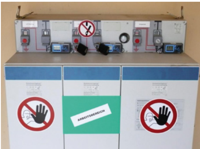
Bild 11: Kennzeichnung bei typgeprüften kompakten Schaltanlagen unter Verwendung einer grünen Farbkennzeichnung für den zum Arbeiten freigegebenen Bereich
