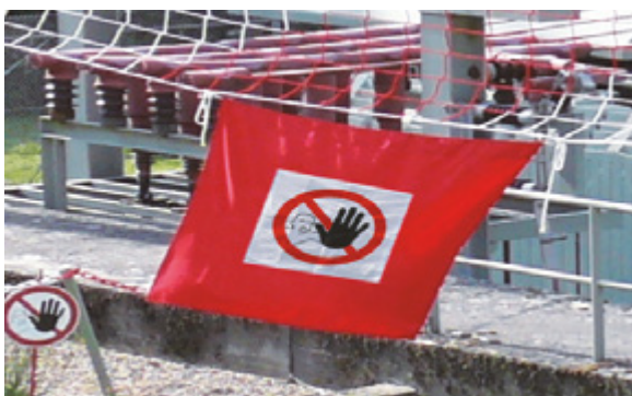
Bild 7: Beispiel zur Kennzeichnung von Gefahrenstellen unter Verwendung von rot-weißen Netzen und Verbotssymbolen beim Kraneinsatz in einer Hochspannungsschaltanlage.
