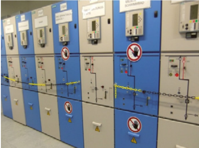
Bild 10: Bei typgeprüften Anlagen in Kompaktbauweise ist es bedingt durch die vermehrten Schottungen in der Anlage und im Schaltfeld möglich, dass auch mehrere Türen/Abdeckungen geöffnet werden können. Hierdurch erhöht sich das Gefährdungspotential.
