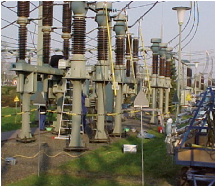
Bild 20: Zeigt einen Erdungswagen für Transport und Lagerung von Erdungsgarnituren.
