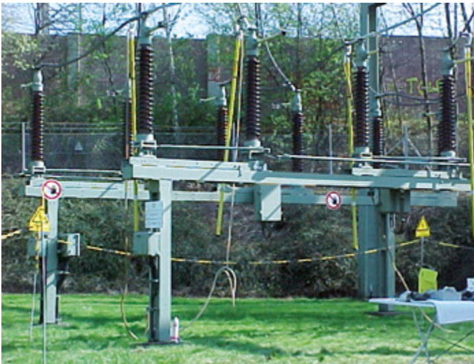
Bild 15: Im Beispiel wird ein abgegrenzter und gekennzeichnete Arbeitsbereich in einer Reihenlängsbauweise errichteten Anlage gezeigt. Durch die Anordnung der eingebauten Erdungseinrichtungen ist der Bezug zur Arbeitsstelle sofort und eindeutig zu erkennen.
