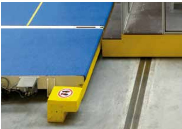
Die Scherstelle zwischen dem Ende der Rollenbahn und dem Transferwagen ist ein gefährlicher, besonders zu sichernder Bereich.
