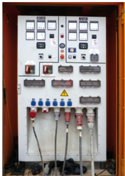
Abb. 14 Anschlussfeld eines Stromerzeugers mit integrierten RCDs
