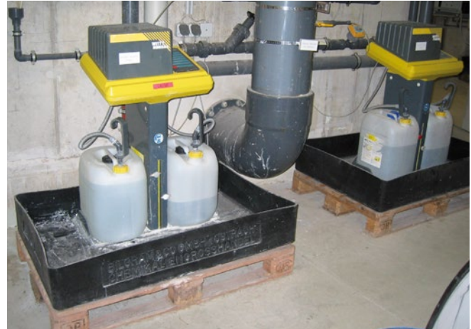
Abb. 11 Behälter mit Flockungsmitteln bei der Entnahme
