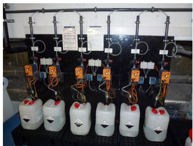
Abb. 10 Dosierstation mit Säure
