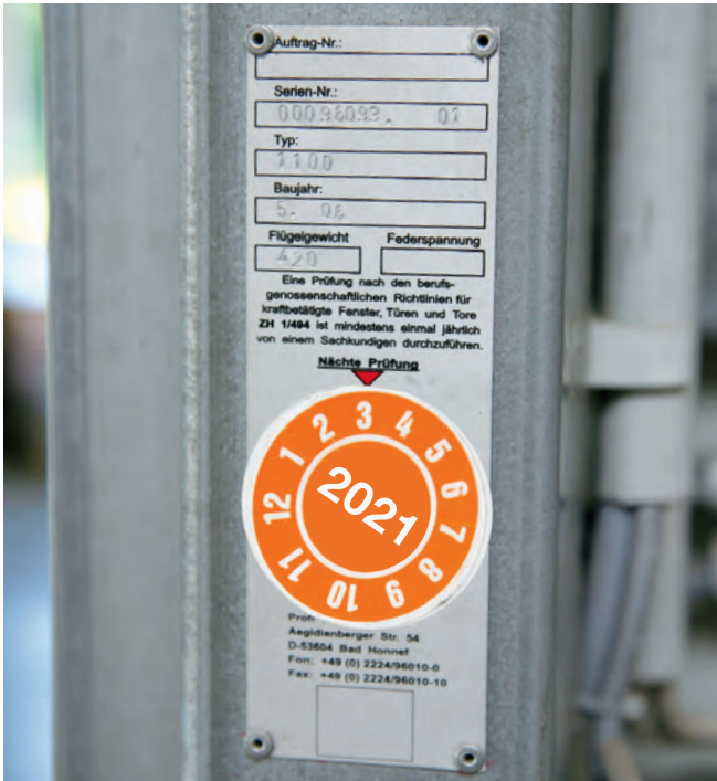
Prüfsiegel an einem elektrischen Rolltor
