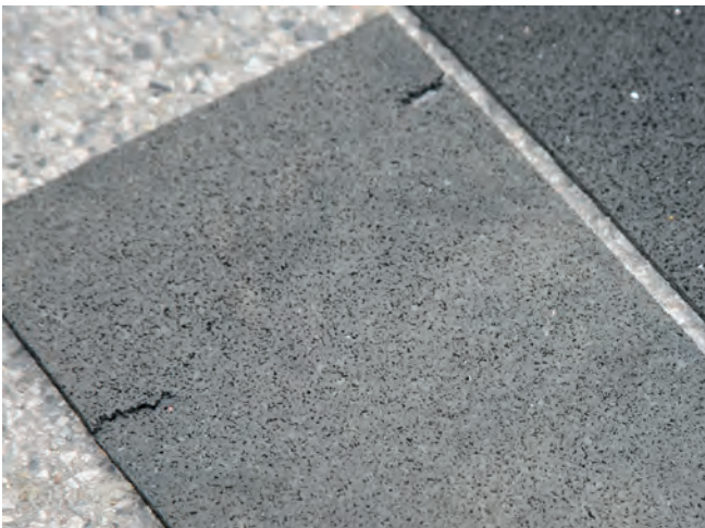
Ablegereife: verschmutzte Oberfläche und ausgebrochene Stellen
