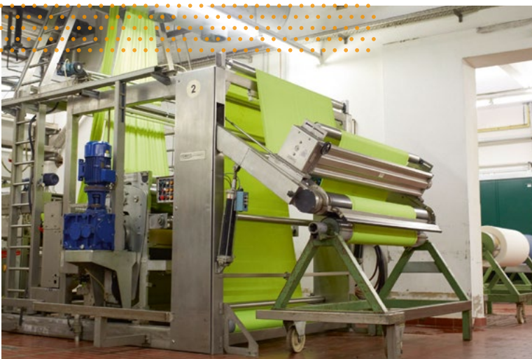
Das Berühren Strom führender Teile an Maschinen und Anlagen muss für elektrotechnische Laien ausgeschlossen sein.
