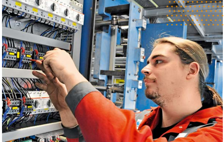
Das darf nur die Elektrofachkraft: Arbeiten am geöffneten Schaltschrank im spannungsfreien Zustand!
