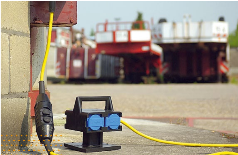
Schutzverteiler mit ortsveränderlicher Schutzeinrichtung und vier Steckdosen
