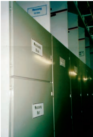
Bild 3.4.3 Beispiel einer mit Vollblechtüren nachgerüsteten Anlage
