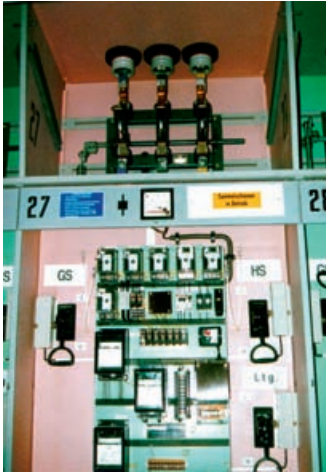
Bild 3.2.2 Nachgerüstete elektromagnetische Verriegelung an den Handgriffen der Trennschalter
