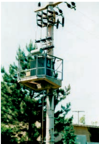
Bild 3.3.4 Freileitungsmaststation mit Trennschalter für den Trafo
