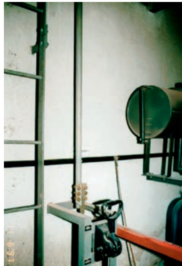
Bild 3.3.2 Antriebshebel in Freileitungsturmstation (Untergeschoss)
