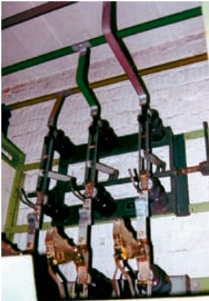
Bild 3.5.1 Lasttrennschalter unter einem Trennschalter
