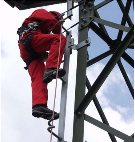
Abb. 10 Beispiel für den Einsatz von Steigbolzen mit Sicherheitseinrichtung am Eckstiel eines Gittermastes.
