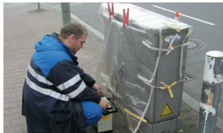
3.3.1 Bild 4 Prüfaufbau mit tragbarem Prüfgerät, Beispiel am KVS
