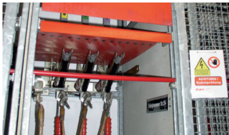
3.3.3 Bild 1 Isolierende Schutzplatten in einer Mittelspannungsanlage
