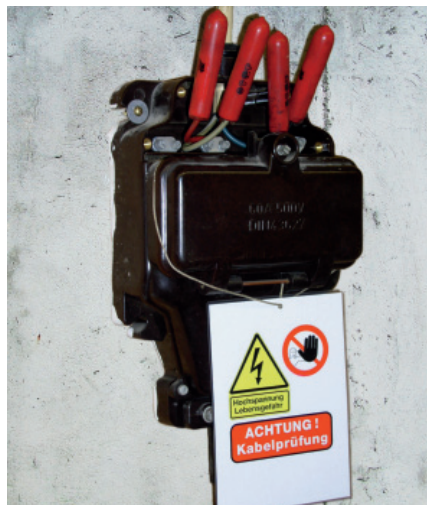
3.3.5 Bild 2 Hausanschlusskasten mit Sicherungs- Schraubelementen. Hier ist die Abgangs- leitung abgeklemmt und isoliert.
