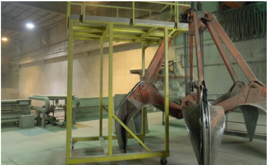
Abb. 14.5.1.2 Beispiel für einen im Bunkerbereich für geringfügige Wartungsarbeiten abgestellten Müllgreifer. Die fahrbare Arbeitsbühne erleichtert die sichere Durchführung der Arbeiten.
