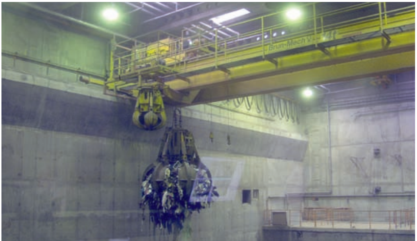
Abb. 14.4.1 Blick in einen Müllbunker mit Müllaufgabetrichter im Vordergrund. Die hinter dem Aufgabetrichter liegende Fläche gestattet ein Begehen des Bereiches und ein Abstellen z.B. von Ersatzmüllgreifern.
