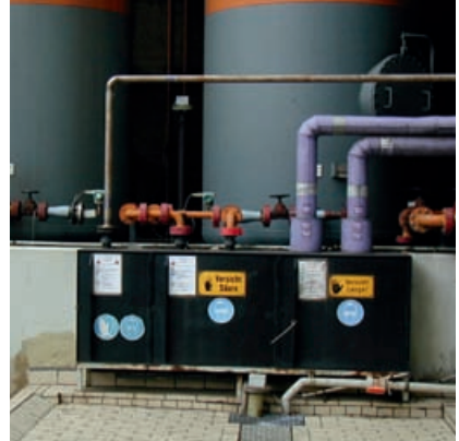
Abb. 12.4.2.2 Kennzeichnung einer Entlade- station. Die spezifischen Anschlussstutzen werden in den Schränken bereitgehalten.
