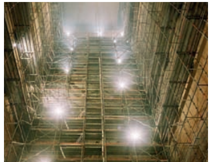
Abb. 8.5.2.2 Beispiel für eine Beleuchtung in einem Dampfkessel
