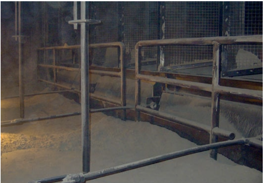
Abb. 8.5.4.1 Beispiel für ein festes Geländer als Absturzsicherung in einem Rauchgaskanal am Übergang zur Entstickungsanlage. Nach Einbringen der Beleuchtung kann mit den Reinigungsarbeiten begonnen werden.
