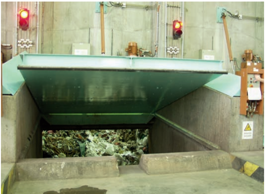
Abb. 14.1.1 Beispiel für eine Entladestelle in einen Müllbunker. Die Einfüllöffnung wird durch eine hydraulisch angetriebene Klappe von einem sicheren Standpunkt aus verschlossen. Eine zweiteilige Schwelle dient als Überfahrtschutz.
