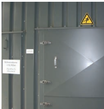
Abb. 8.1.4 Auf die bestehende Absturzgefahr hinter einer Kassettenabdeckung wird durch das Sicherheitskennzeichen „Warnung vor Absturzgefahr“ hingewiesen. Durch Befestigung des Zeichens oberhalb der Kassettenabdeckung ist der Warnhinweis auch bei geöffneter Einstiegsöffnung sichtbar.
