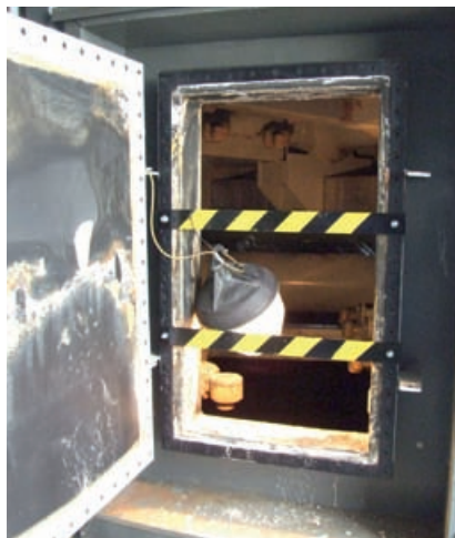
Abb. 8.1.5 Hinter der geöffneten Einstiegs Luke besteht Absturzgefahr. Daher ist die Absturzstelle mit festen Absperren gesichert.
