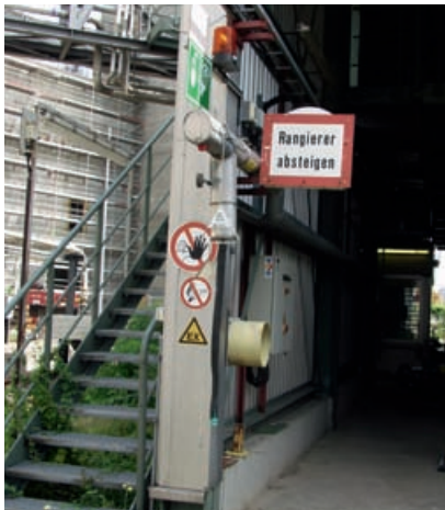
Abb. 12.1.1.1 Eingehauste Beladeanlage für Flugstäube mit Sicherheitskennzeichnung
