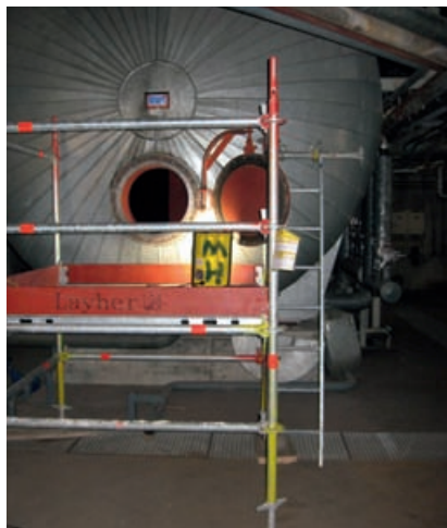
Abb. 8.1.3 Beispiel für eine Einstiegsöffnung mit Zugangs- und Rettungsplattform
