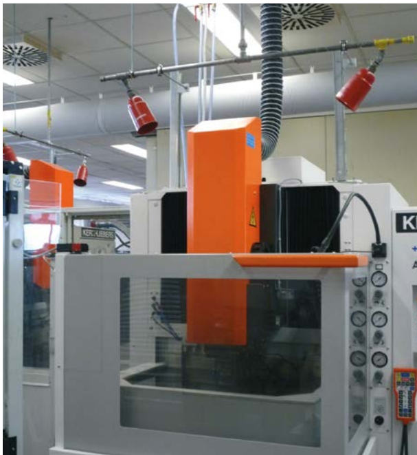
Absaugung und automatische CO 2 -Löschanlage an einer Funkenerodiermaschine.
