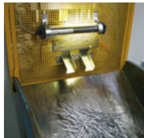
Feste Verdeckung mit Lochblech an der Rückseite der Presse. Somit kann auch von hinten niemand in den Pressenraum eingreifen.
