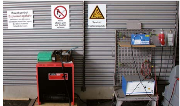
Ein gut belüfteter Batterieladepplatz ohne brennbares Material in der Nähe. Auch die Kennzeichnung mit Warnzeichen und Verbotsschildern ist vorbildlich.
