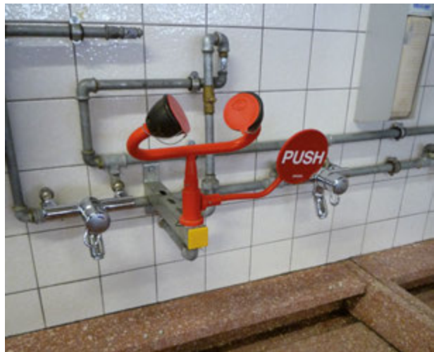
Wo mit Säuren und Laugen gearbeitet wird, sollte eine Augendusche in der Nähe sein.
