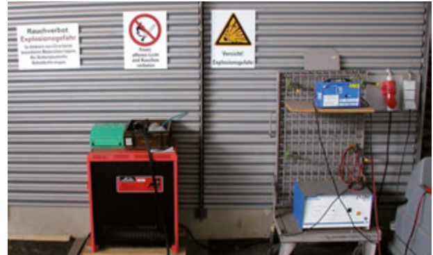
Ein gut belüfteter Batterieladepplatz ohne brennbares Material in der Nähe. Auch die Kennzeichnung mit Warnzeichen und Verbotsschildern ist vorbildlich.
