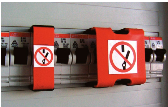
Sperrelemente zeigen eindeutig, an welchem Stromkreis gearbeitet wird. Sperrelemente mit zusätzlichen Arretierungen können unberechtigtes Wiedereinschalten noch wirksamer verhindern.
