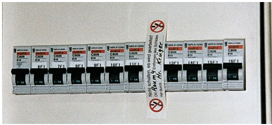
Klebefolie an einem nicht herausnehmbaren Leitungsschutzschalter.
