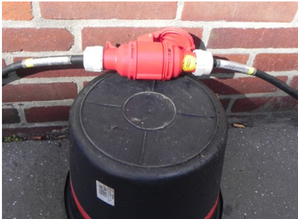
Geprüfte Stecker mit Gummischlauchleitungen
