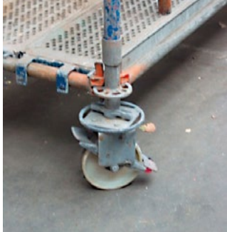
Sicher befestigte und gebremste Rolle eines fahrbaren Arbeitsgerüsts
