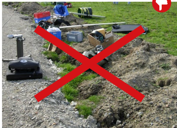
So bitte nicht! Dieses sollte ein Verkehrsweg darstellen! Sicherung eines Verkehrsweges
