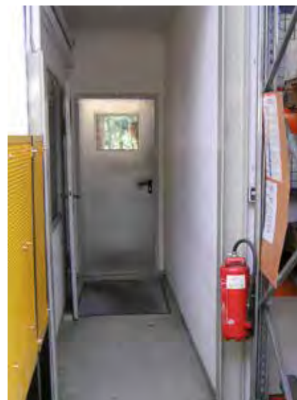
So hängen die Feuerlöscher richtig. Im Bild oben aber ist der Zugang durch abgestellte Teile behindert, das darf nicht sein.
