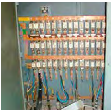
Verteilung mit offenen NH-Sicherungsleisten
