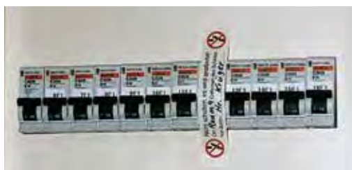
Klebefolie an einem nicht herausnehmbaren Leitungsschutzschalter.
