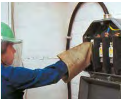
Schutzmaßnahmen beim Einsetzen und Herausnehmen von NH-Sicherungseinsätzen
