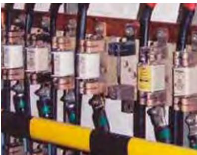
Ungeschützte NS-Verteilungen führen immer wieder zu Stromunfällen.
