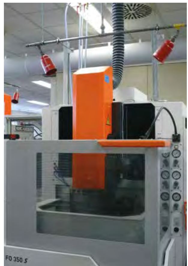
Absaugung und automatische CO 2 -Löschanlage an einer Funkenerodiermaschine
