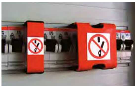
Sperrelemente zeigen eindeutig, an welchem Stromkreis gearbeitet wird. Sperrelemente mit zusätzlichen Arretierungen können unberechtigtes Wiedereinschalten noch wirksamer verhindern.
