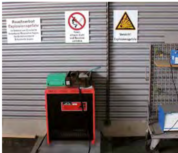
Ein gut belüfteter Batterieladeplatz ohne brennbares Material in der Nähe. Auch die Kennzeichnung mit Warnzeichen und Verbotsschildern ist vorbildlich.
