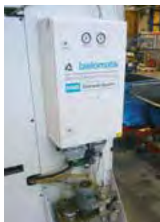
Diese kleine Einheit ist das Versorgungssystem der Minimalmengenschmierung an einem Bearbeitungszentrum.
