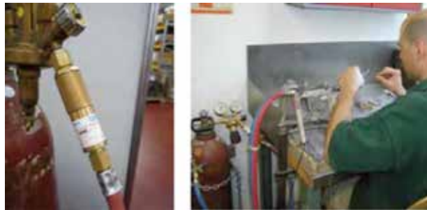
Die Sicherung gegen Flammrückschlag ist direkt nach dem Druckminderer an den Gasflaschen eingebaut.
