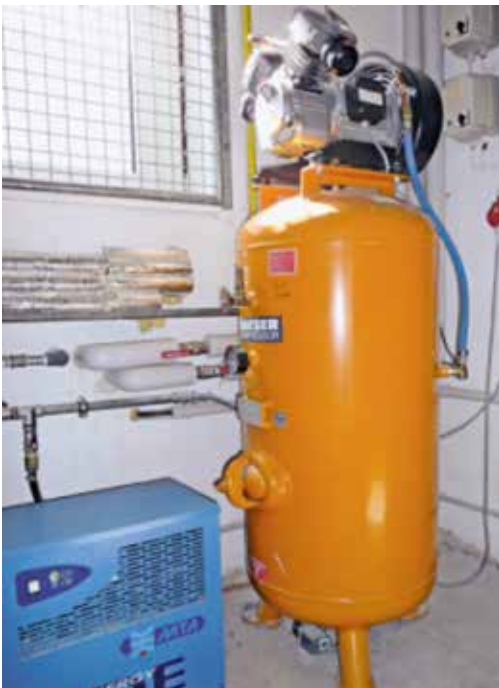
Durch zugelassene Überwachungsstelle zu prüfender Druckbehälter
