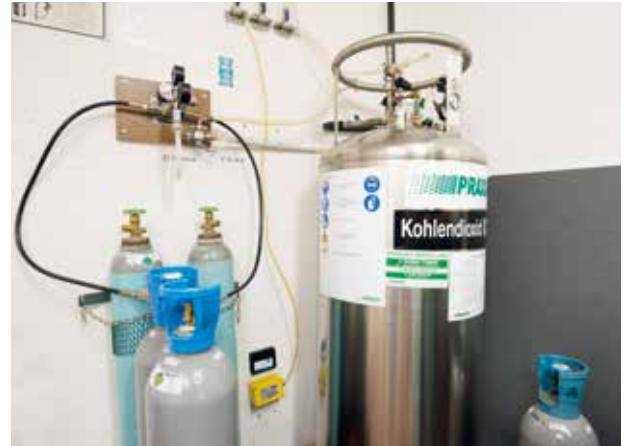
Das Gaswarngerät (Bildmitte unten) sollte ca. 30 cm über dem Fußboden befestigt werden.
