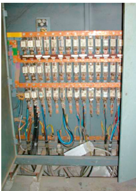
Verteilung mit offenen NH-Sicherungsleisten
