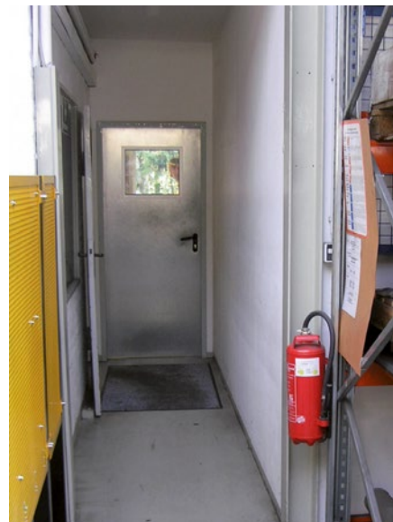
So hängen die Feuerlöscher richtig. Im Bild oben aber ist der Zugang durch abgestellte Teile behindert, das darf nicht sein.
