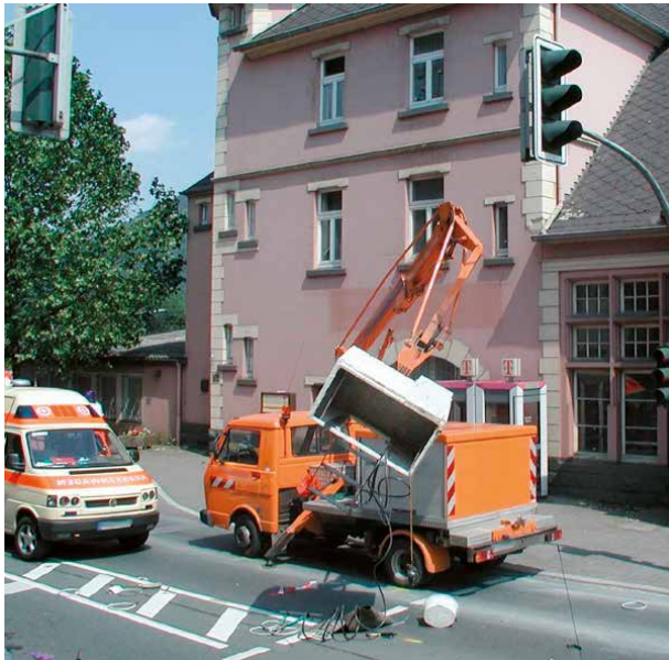
Tödlicher Sturz aus dem Arbeitskorb
