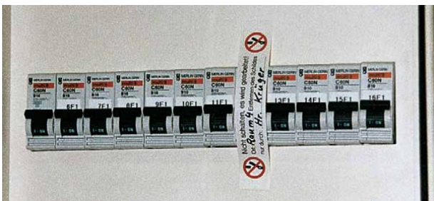
Klebefolie an einem nicht herausnehmbaren Leitungsschutzschalter
