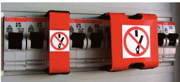
Sperrglieder zeigen eindeutig, an welchem Stromkreis gearbeitet wird. Sperrglieder mit zusätzlichen Arretierungen können unberechtigtes Wiedereinschalten noch wirksamer verhindern.
