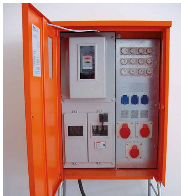
Baustromverteiler als Speisepunkt
