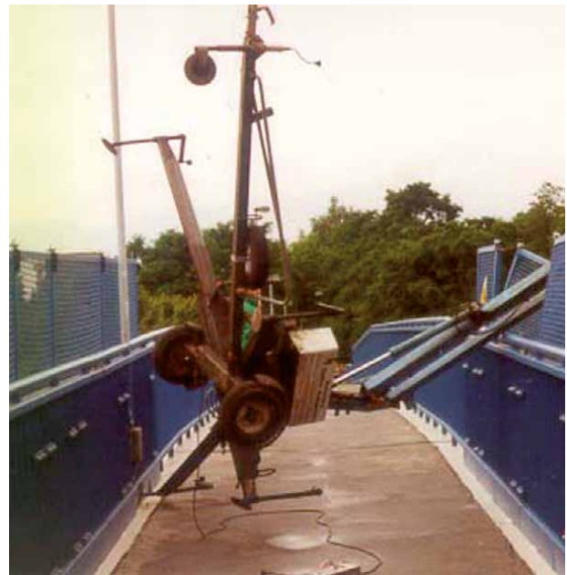
Wegen unzureichender Standsicherung der Hubarbeitsbühne stürzte ein Elektromeister aus 9 m Höhe auf ein Bahngleis.
