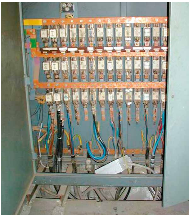
Verteilung mit offenen NH-Sicherungsleisten
