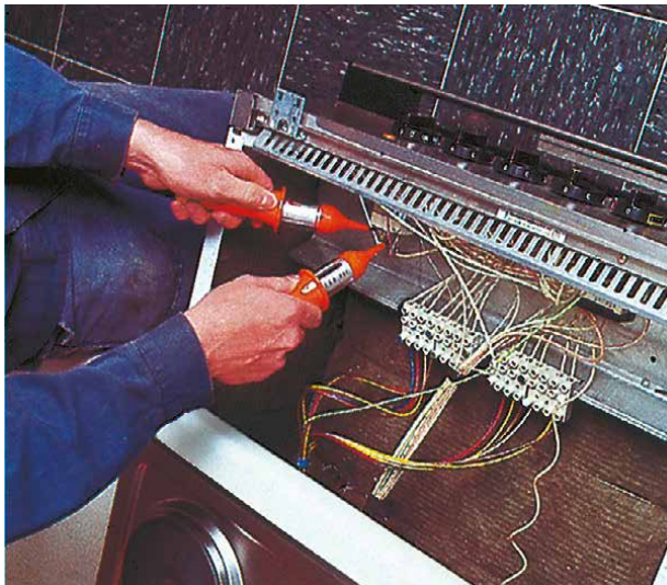
Feststellen der Spannungsfreiheit an der Arbeitsstelle, hier an einem Elektroherd
