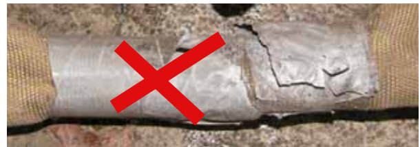
„Reparaturen“ wie diese sind absolut ungeeignet und deshalb verboten; sie täuschen Sicherheit vor – das kann ein tödlicher Irrtum sein.
