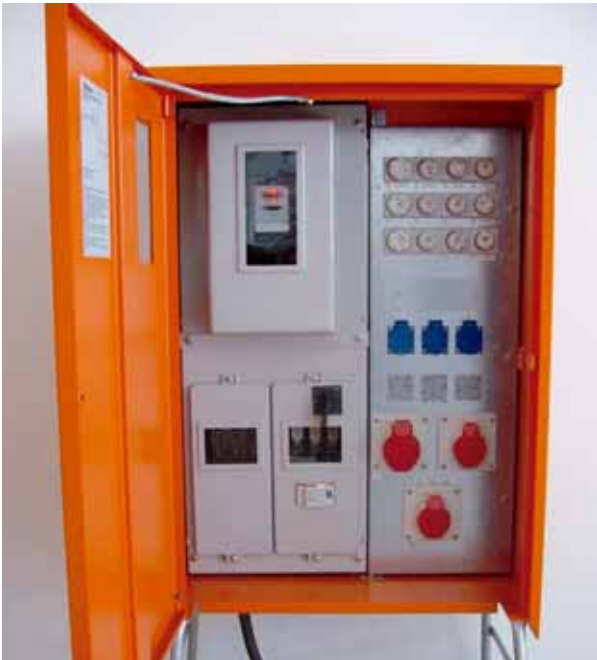
Baustromverteiler als Speisepunkt
