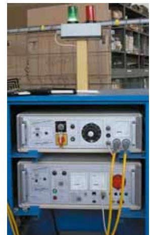
Hochspannungsprüfgerät mit Signalleuchten
