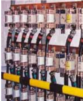
Ungeschützte NS-Verteilungen führen immer wieder zu Stromunfällen
