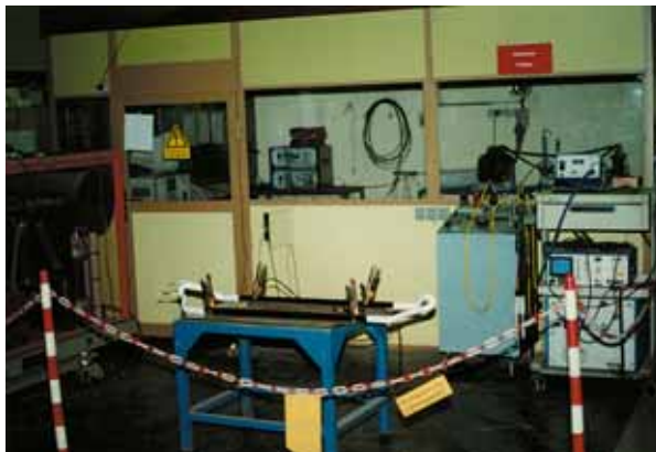
Weil dieser Prüfplatz nicht mit zwangsläufigem Berührungsschutz ausgestattet war, kam es beim Prüfen von Roebelstäben zu einem tödlichen Stromunfall.
