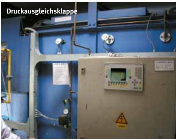
Ein Pyrolyseofen mit Druckausgleichsklappe. Die Klappe muss während des Ofenbetriebes unbedingt freigehalten werden.
