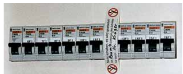
Klebefolie an einem nicht herausnehmbaren Leitungsschutzschalter
