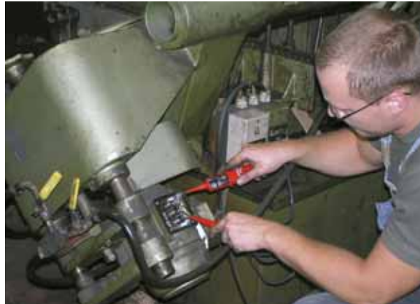
An der Arbeitsstelle immer erst die Spannungsfreiheit prüfen und sichern.
