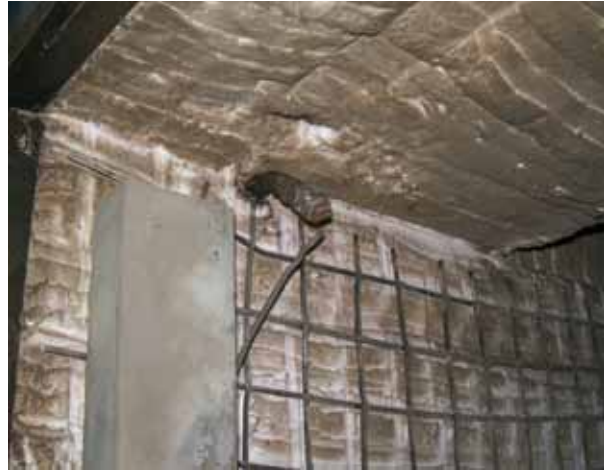
Wenn in diesem Ofen ein Brand entsteht, werden über Sensoren Wasserdüsen zum Löschen aktiviert.
