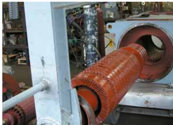
Eine spezielle Traverse als Anschlagmittel für den sicheren und exakt steuerbaren Transport eines Kollektors.
