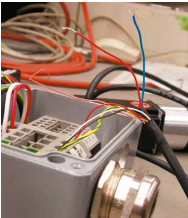
An diesem Motor kam es zu einem Stromunfall, weil Leitungen verwechselt wurden.
