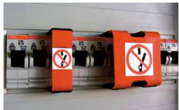
Sperrglieder zeigen eindeutig, an welchem Stromkreis gearbeitet wird. Sperrglieder mit zusätzlichen Arretierungen können unberechtigtes Wiedereinschalten noch wirksamer verhindern.
