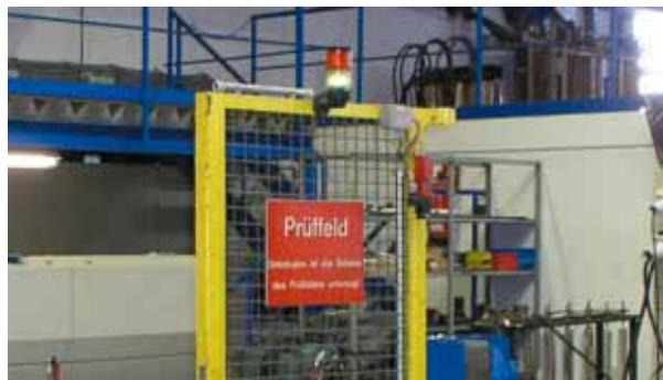
Signalleuchten zeigen den Betriebs- und Schaltzustand an: Im oberen Bild rot für „In Betrieb“, im unteren Bild grün für „Betriebsbereit“.
