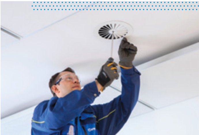
Einregulierung am Luftdurchlass
