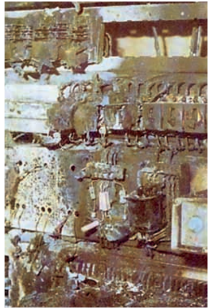
Bild 3.1: Zerstörungen in einer Anlage nach einem Störlichtbogenunfall (Quelle: Schau)
