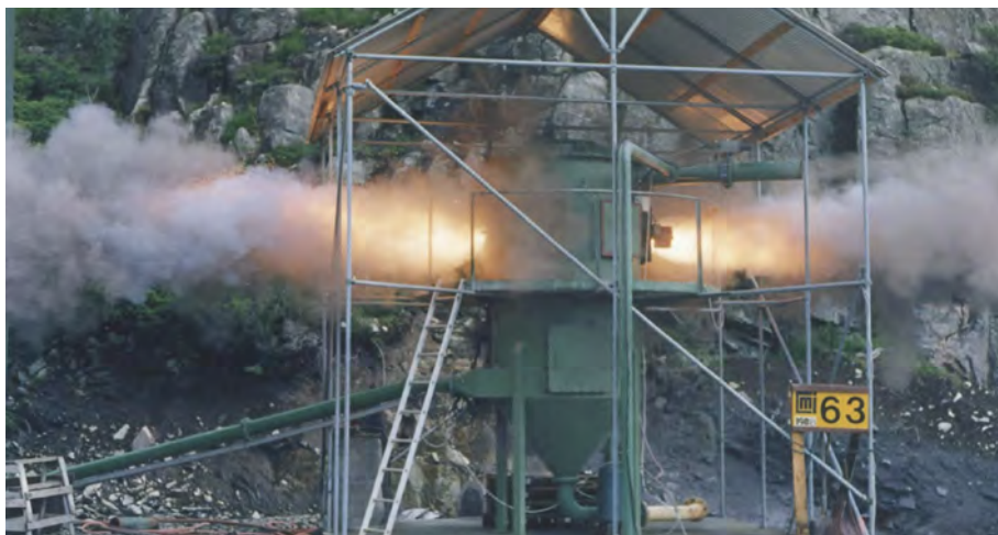
Σιλό με θύρες εκτόνωσης
