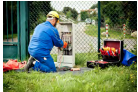
Rechts im Bild: Werkzeugtasche mit isoliertem Werkzeug für das Arbeiten an unter Spannung stehenden Teilen
