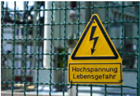
Gute Kennzeichnung der Arbeitsgrenzen in einer Freiluft-Schaltanlage
