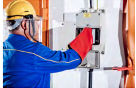
Ziehen eines NH-Sicherungseinsatzes
