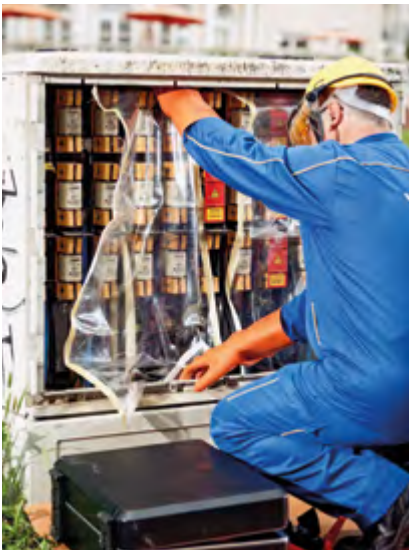
Abdecken benachbarter, unter Spannung stehender Teile
