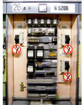
Eine wirkungsvolle Kennzeichnung kann die Gefahr eines „versehentlichen“ Wiedereinschaltens abwenden.
