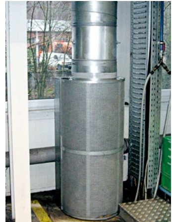
Abb. 20: Zuluftauslass im Arbeitsbereich im Bodenbereich
