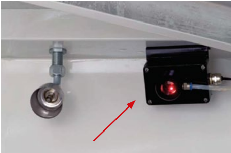
Abb. 35: Branderkennungselement im Innenraum einer Maschine
