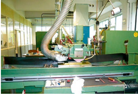
Abb. 18: Offenes Erfassungssystem (Saugtrichter) an einer Flachsleifmaschine
