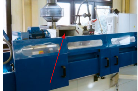
Abb. 17: Halboffene Erfassung mit Absaugung und Fortluftbetrieb beim Rundschleifen
