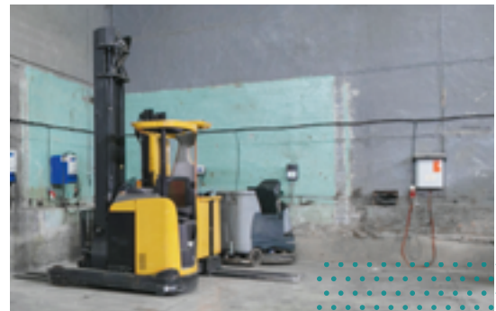
Elektrisch betriebene Flurförderzeuge während des Ladens
