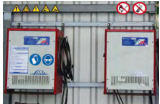
Ladestationen für elektrisch betriebene Flurförderzeuge
