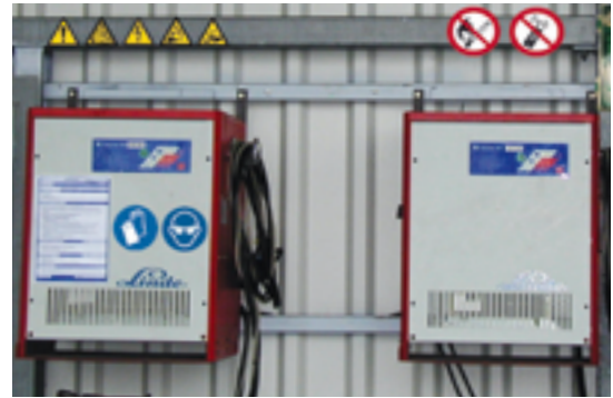
Ladestationen für elektrisch betriebene Flurförderzeuge
