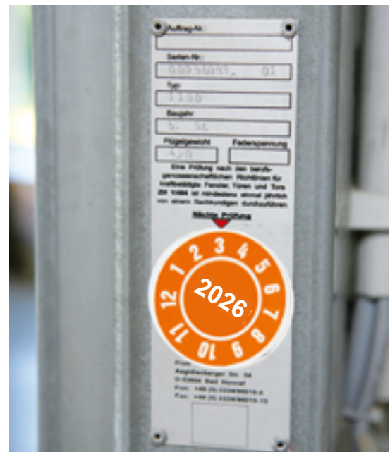
Prüfsiegel an einem elektrischen Rolltor
