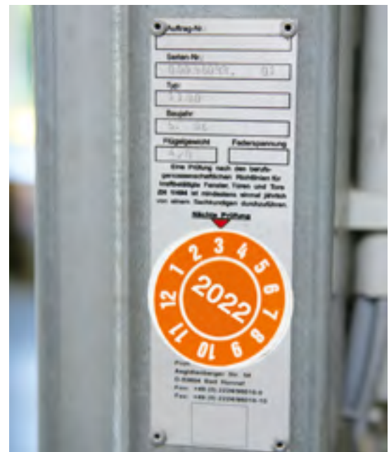
Prüfsiegel an einem elektrischen Rolltor
