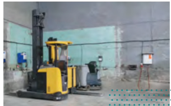
Elektrisch betriebene Flurförderzeuge während des Ladens
