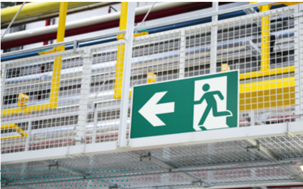
Fluchtwege müssen gekennzeichnet sein.
