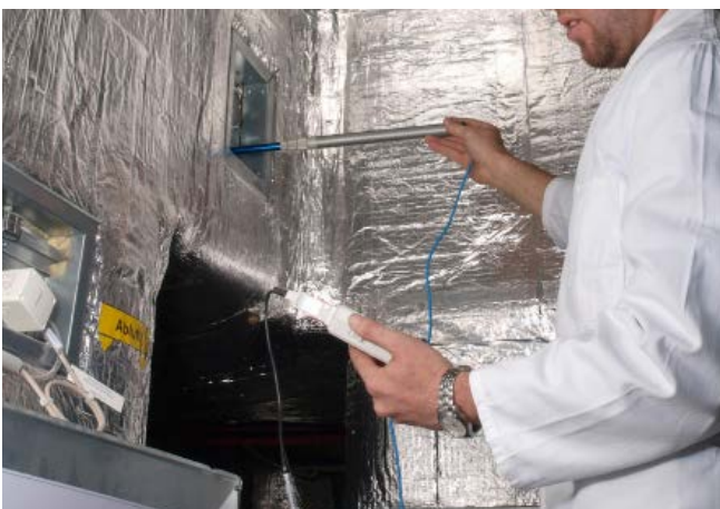
Ermittlung des Luftvolumenstromes in einer Luftleitung
